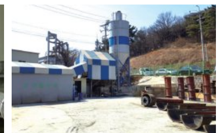
콘크리트기초 생산 설비
