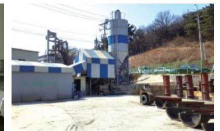
콘크리트기초 생산 설비
